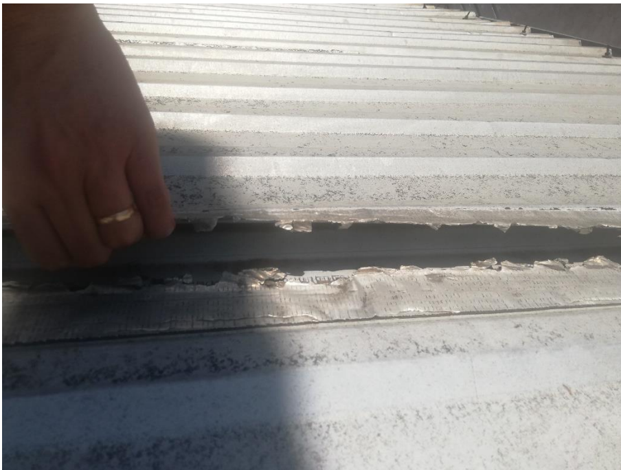
Unión entre calaminas, se debe retirar la membrana en mal estado y colocar la nueva.
