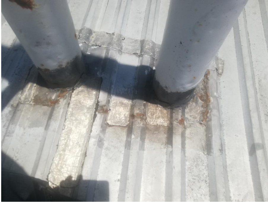
Uniones donde se debe aplicar la masilla
