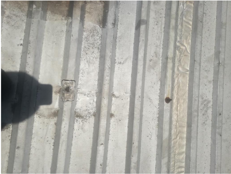
Ganchos oxidados que deben ser reemplazados
